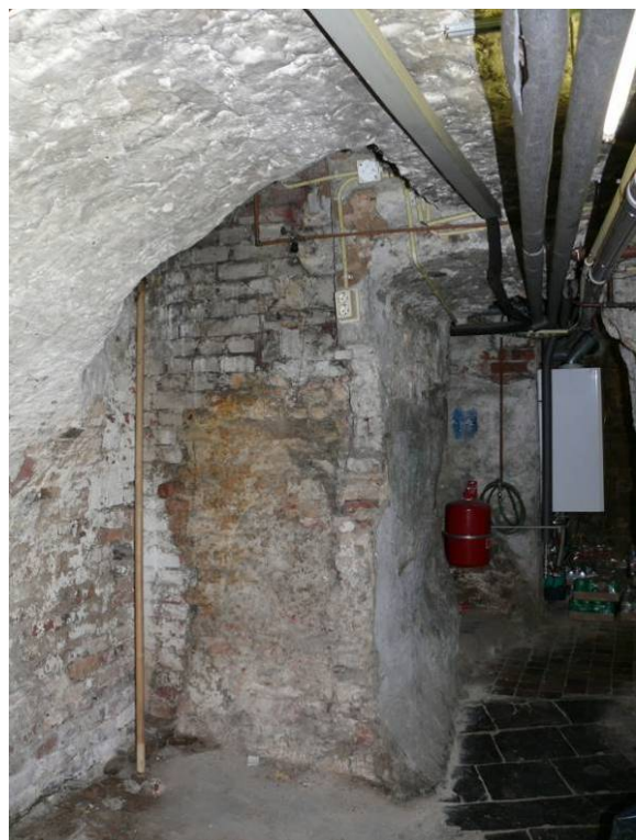
8 dichtgezette, secundaire toegang aan achterzijde (links)
