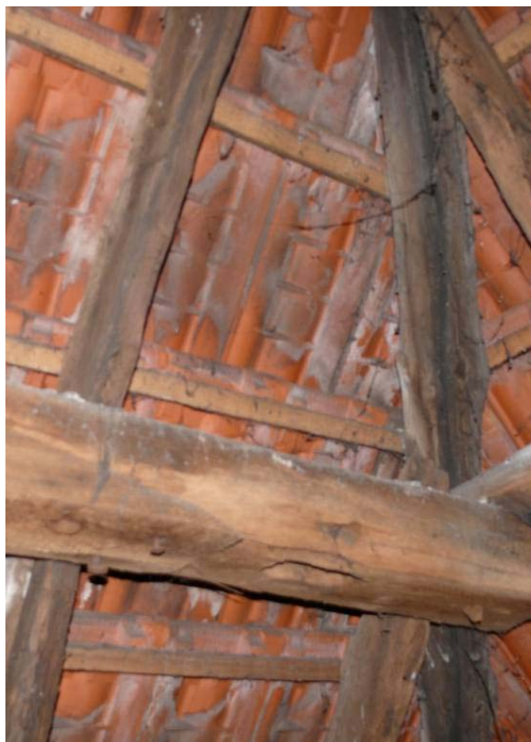
Pengat van een verdwenen windschoor aan de achterzijde
