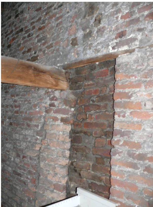
Dichtgezette doorgang tussen nr. 13 en nr.15
